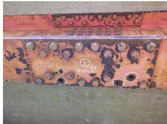
ボルトの脱落
