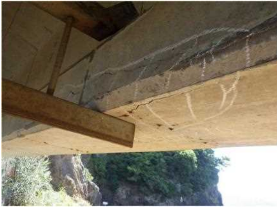
コンクリートのひびわれ
