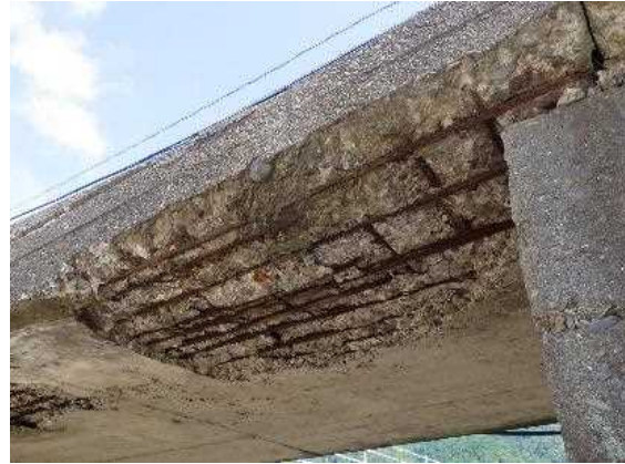
コンクリートの鉄筋露出
