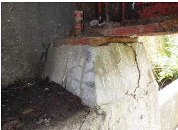
支承台座のひびわれ
