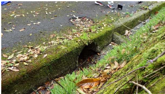
写真③ 変形箇所（側溝側）
